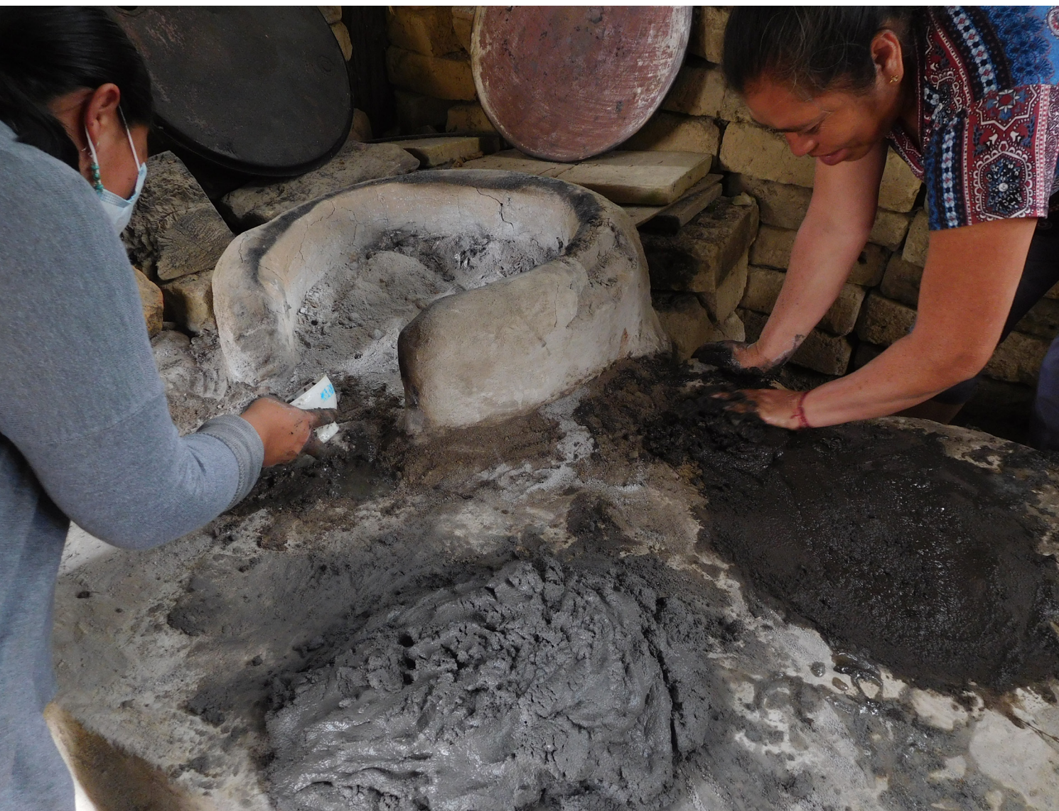
Figura 6. Relleno y reparación de grietas en el tlecuil y pretil Relleno de cavidades, grietas y fisura del tlecuil y pretil.
